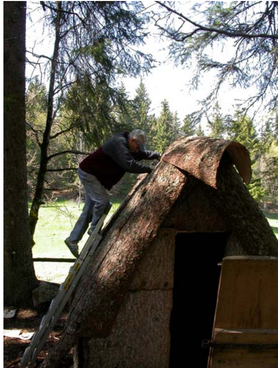
Le posage de l'écorce faitière scelle en quelque sorte la fin des travaux
